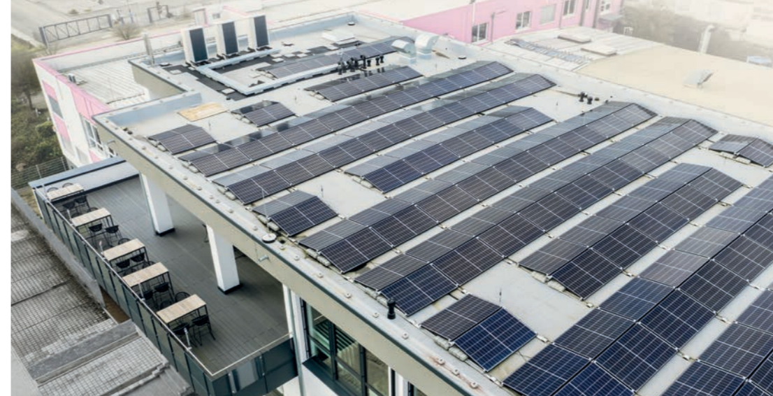
Photovoltaikanlage auf Gebäude/Werk 3B
